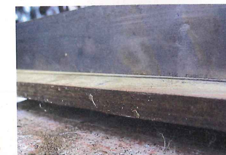
... ist das massive Teil doch leicht nach unten durchgebogen. Das kann eigentlich nur durch unkorrektes Absetzen des Balkens an Hängen ...
